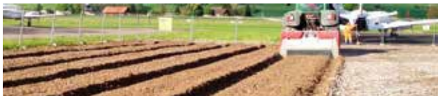
Vegetationsbærelag ved hjælp af jordbundsforbedring: Skærver arbejdes ind i den eksisterende overjord
